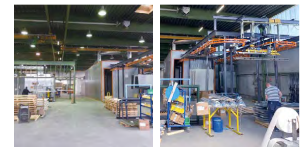
LED照明切り替え前
