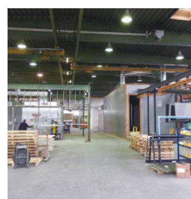
LED照明切り替え前
