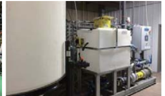
ODCルイスタウン工場 塗装排水システム
