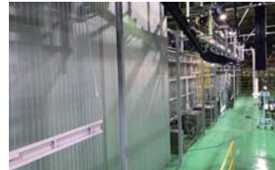
太田ドア工場の仕上塗装ライン
