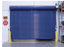
Fireproof shutter (ODC)
