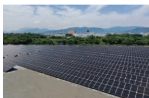
三和シャッター工業九州工場の太陽光発電設備
