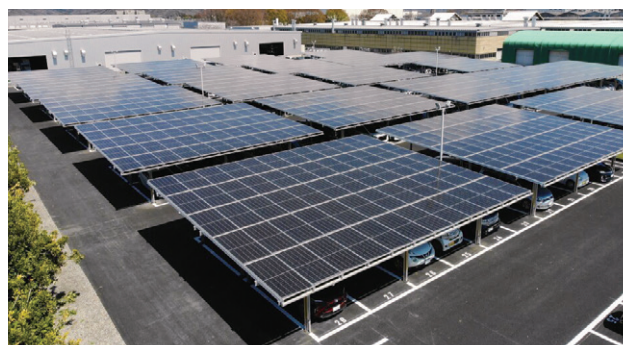
太田ドア工場ソーラーカーポート
